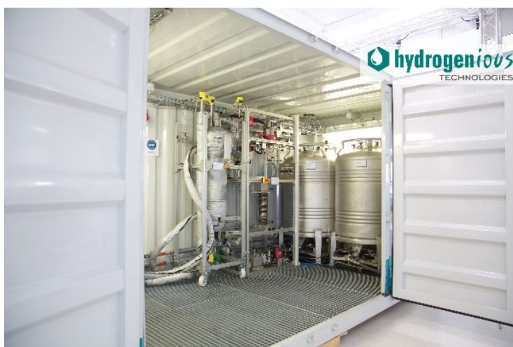
Abbildung 24: Pilotanlage zur Speicherung von Wasserstoff in LOHC (Hydrogenious StorageBOX)
